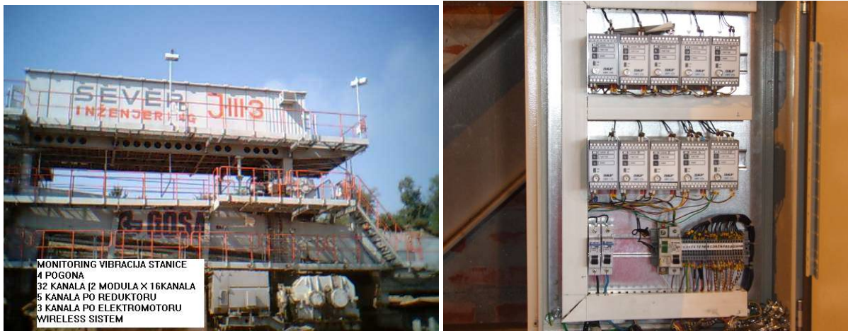
Slika 5. Monitoring vibracija- stanica, orman sa ugrađenim višekanalnim sistemom
